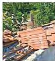
Des dégâts ont été causés au mur qui entoure le cimetière.
