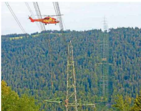
Swissgrid remplace les bras lourds de trois à quatre tonnes de 56 pylônes sur les 140 situés sur la ligne électrique de Bassecourt-Mühleberg, au moyen d'un hélicoptère venu d'Autriche. PHOTO YANNI BEGUELIN
