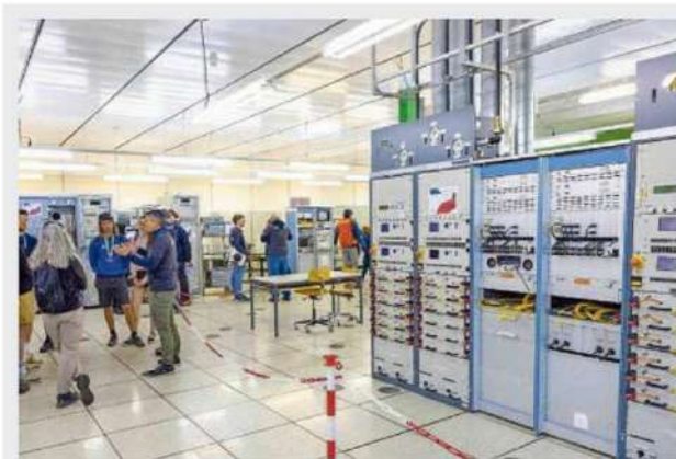
À l'intérieur de l'émetteur de Chasseral, les nouveaux outils informatiques, plus petits, ont permis de gagner de la place.
