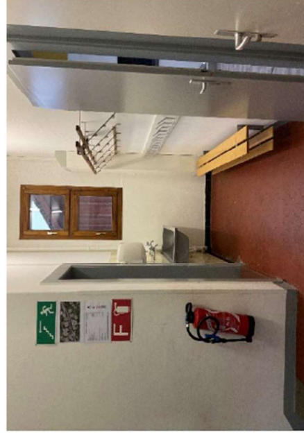
vestiaire tableau électrique
