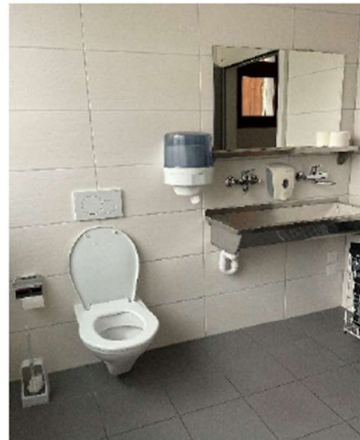
sanitaire WC et boiler
